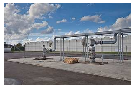
Figuur 10: Geothermie installatie van Green Well Westland in Honselerdijk.
